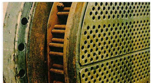
원유 정제소에 있는 분별 증류 시설의 도관 헤드 부분. 도관 내부와 외부에 코팅, 사용 5년 경과 후.
